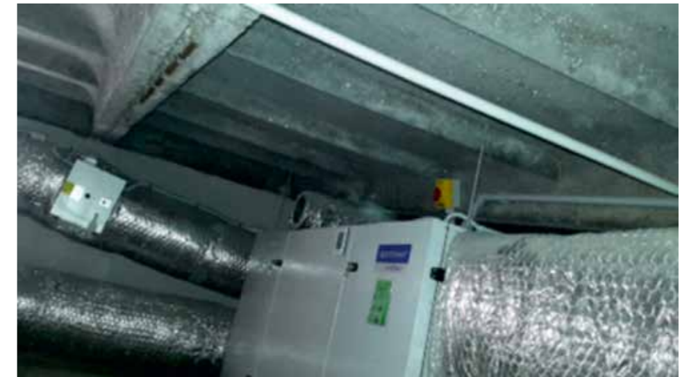
3.2 pav. Šilumogrąžos įrenginys daugiabučio namo techniniame aukšte
