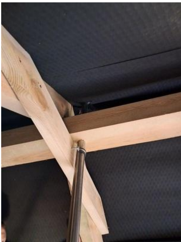
pav. 9. Netinkamas priešgaisrinių reikalavimų įgyvendinimo pavyzdys, metalinis apsaugos nuo žaibo vamzdis eina per medines konstrukcijas jų neapsaugant.
