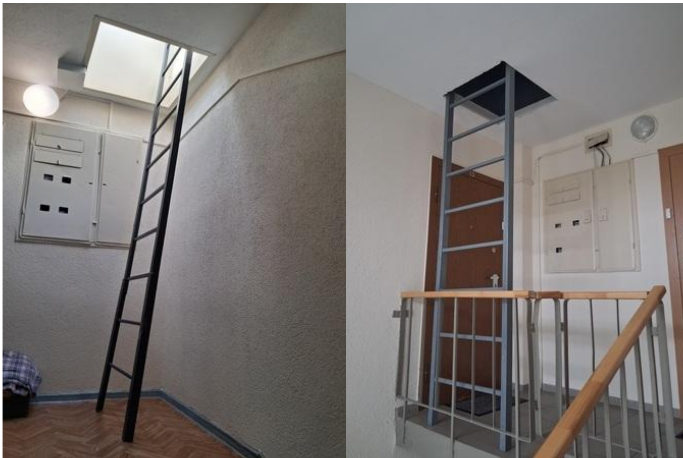
pav. 6. Tinkamas priešgaisrinių reikalavimų įgyvendinimo pavyzdys, nes nėra užstatytas evakuacinis išėjimas ir įrengtos stacionarios kopėčios.
