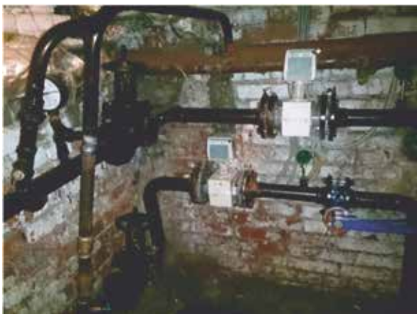
12.3 pav. Senas elevatorinis šilumos punktas
