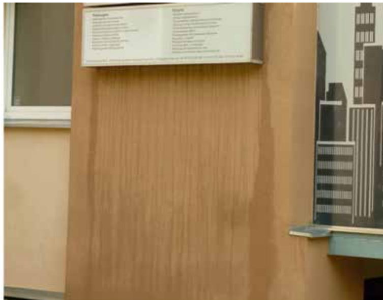
7.8 pav. Dėmėtas fasadas dėl neteisingo iškabos tvirtinimo
