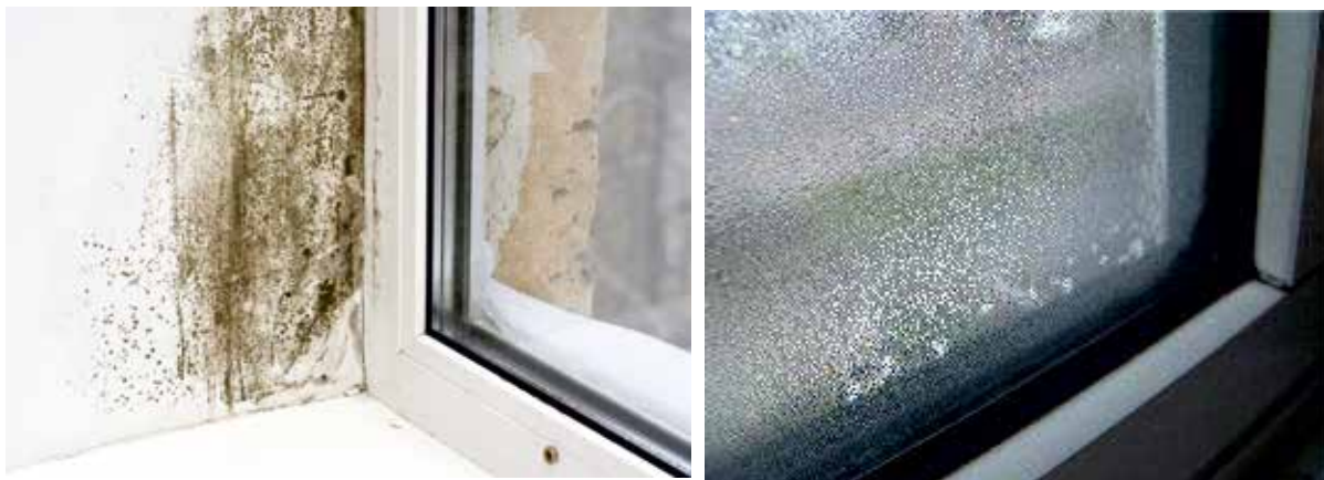
13.4 pav. Dėl per didelės santykinės oro drėgmės ant išorinės sienos atsiradęs pelėsis ir rasojančys langai
