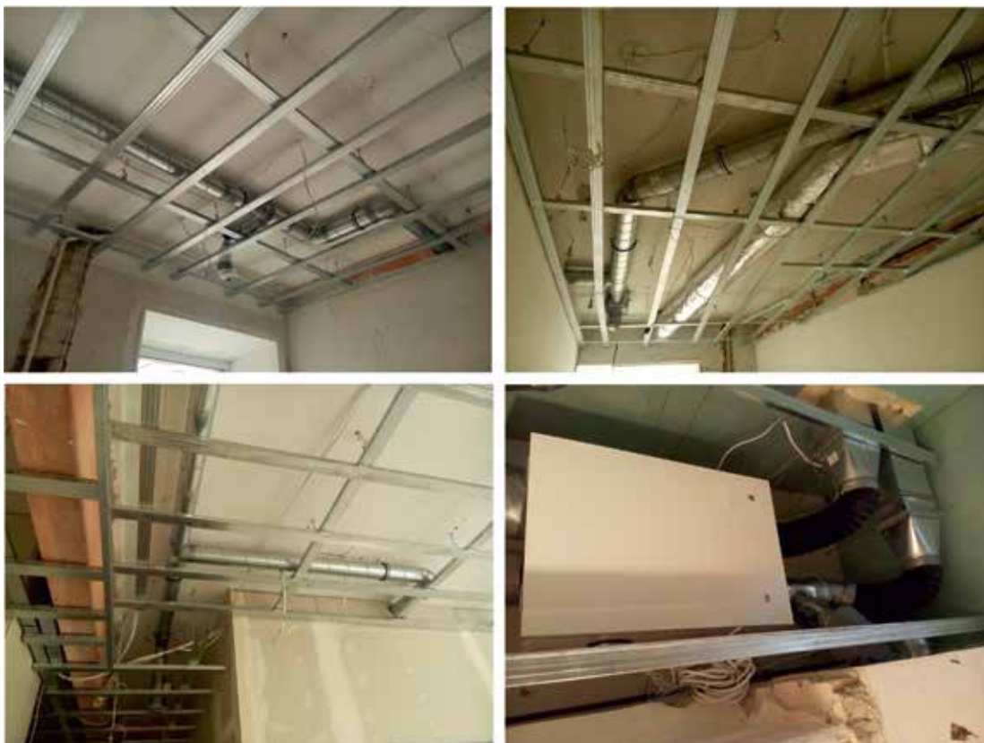
13.16 pav. Decentralizuota mechaninė vėdinimo sistema su šilumos rekuperacija montavimo metu (naudojami cinkuotos skardos ortakiai)
