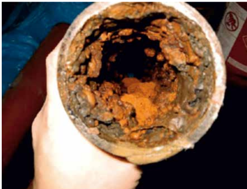
11.8 pav. Korozijos paveiktas vamzdis
