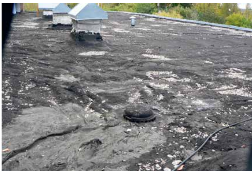
10.4 pav. Plokščio stogo su nusidėvėjusia danga fragmentas
