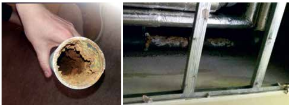
14.6 pav. Korozijos pažeistas vamzdynas
