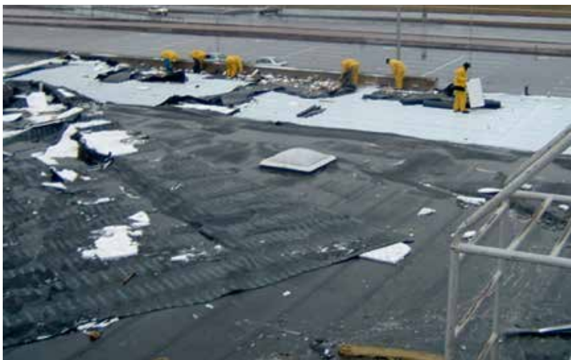
10.2 pav. Vėtros nuplėštas nepakankamai sutvirtintas prekybos centro plokščias stogas
